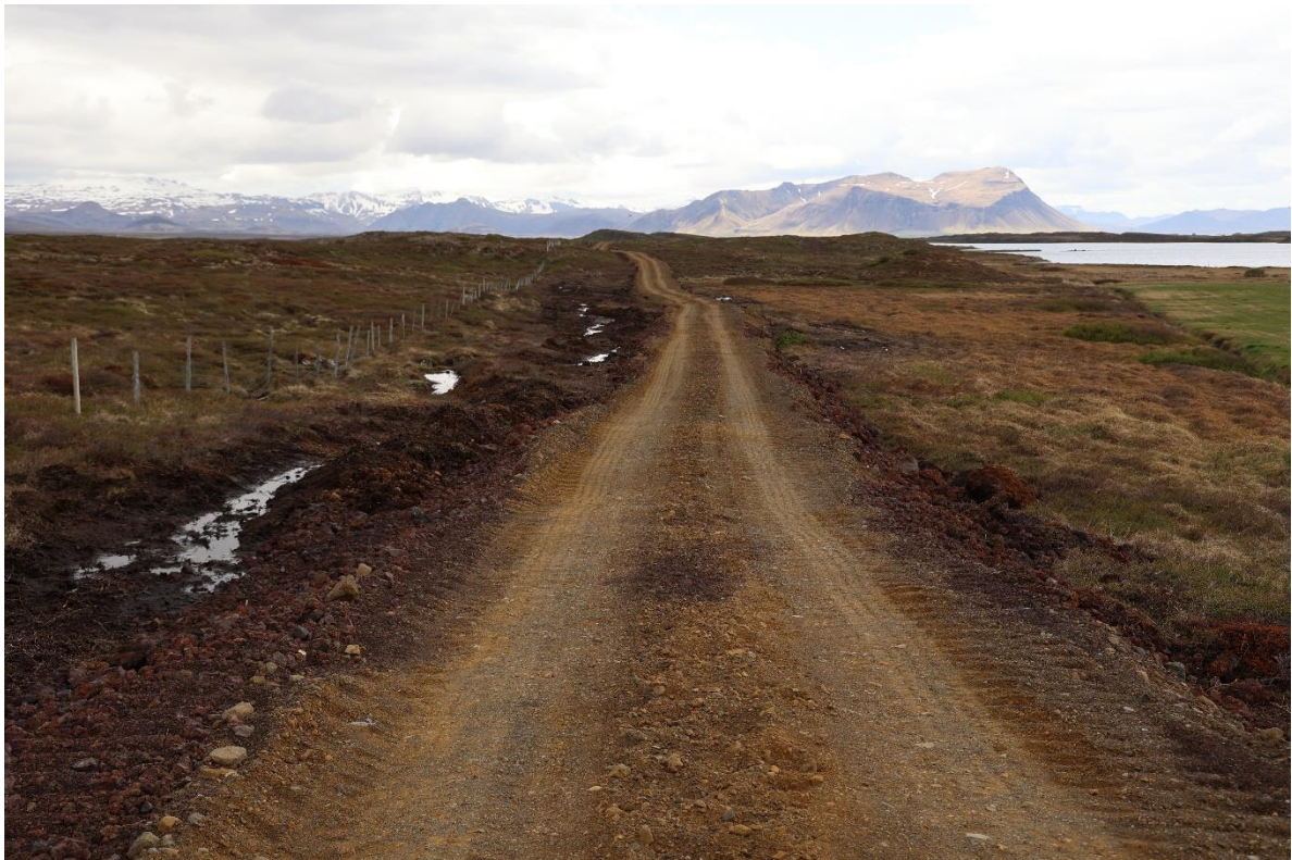
Mynd V2. Vegurinn myndar fyrirstöðu fyrir vatnsrennsli undan halla og safnast vatnið því að einhverju leyti upp vinstra (suðaustan) megin við veginn. Þarna gæti átt við að setja lítið ræsi í gegnum veginn. Staðsetning (VOT820): N65.04259° W22.77403°.
